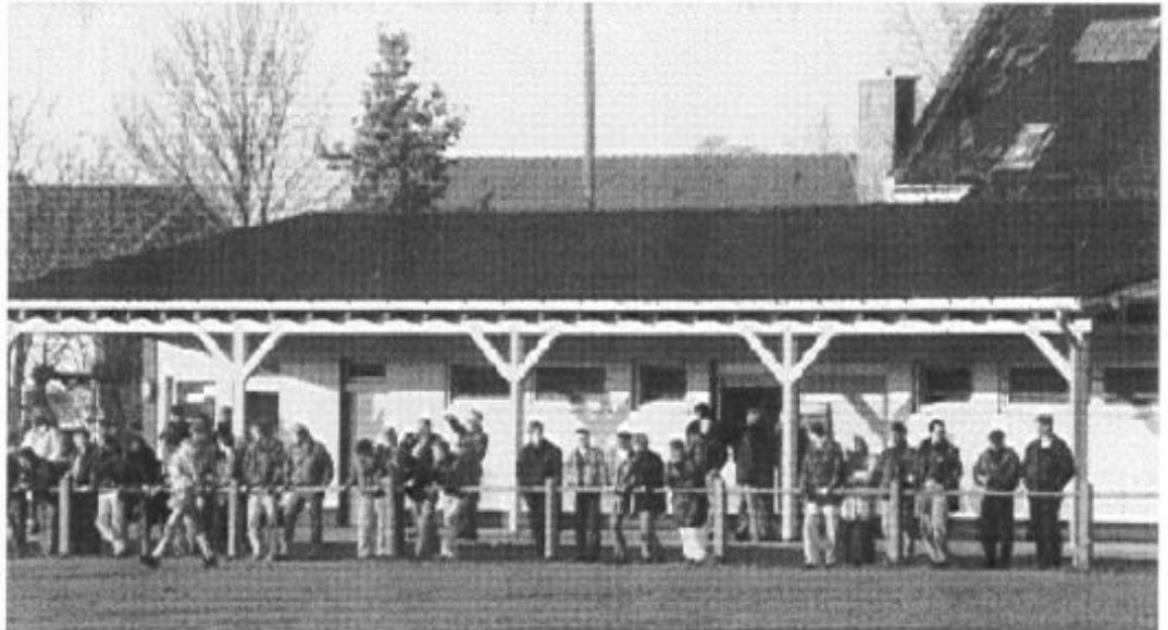
Erst vor ca. 5 Jahren wurde das Sportheimdach völlig neu eingedeckt. Inzwischen haben die Eternitplatten derart viele Risse, daß nur eine Komplettsanierung infrage kommt. Viel Arbeit wartet!
